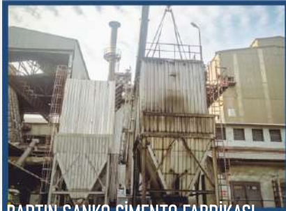
BARTIN SANKO ÇİMENTO FABRİKASI Eski toz toplama sisteminin demontajı ile yeni toz toplama sisteminin imalatı ve montajı yapılmıştır.
